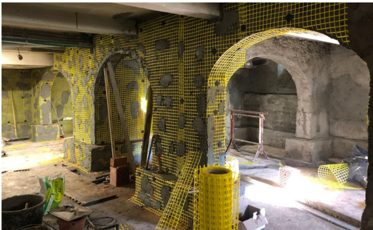
Illustration der Anwendung des SEALBAND-Gewebes in Kombination mit der Dichtschlämme CERMIPROOF SEAL G
